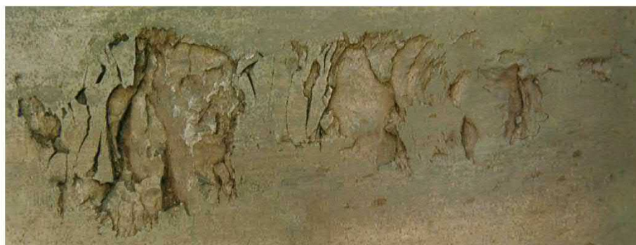
Obr. 5.40 Kolejnice – vydrolování materiálu na povrchu
