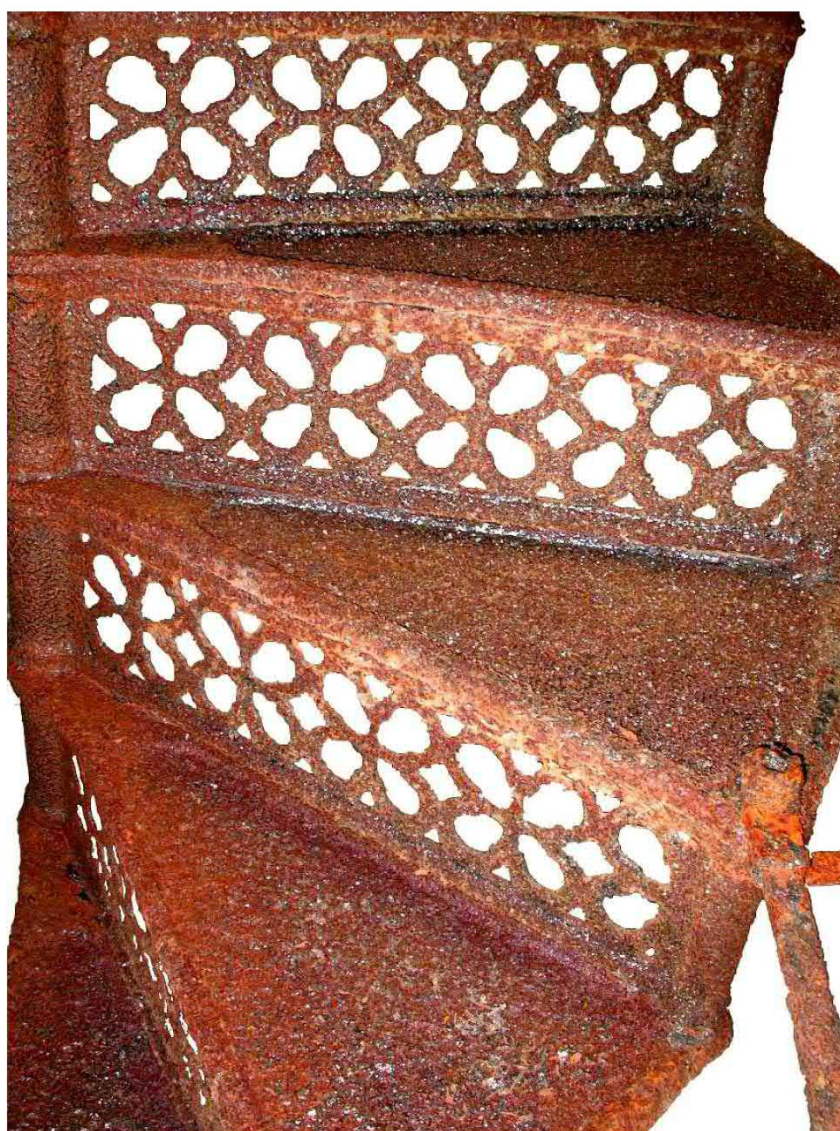
Korozní opotřebení kovových schodů
