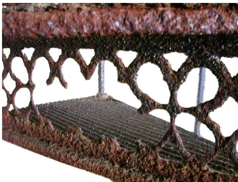
Detail vypadnuté části na točivých schodech
