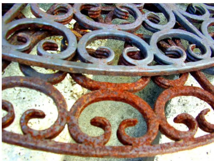
Korozní opotřebení kované brány
