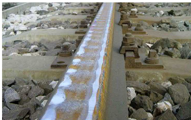
Obr. 5.30 Kolejnice s extrémní vlnkovitostí
