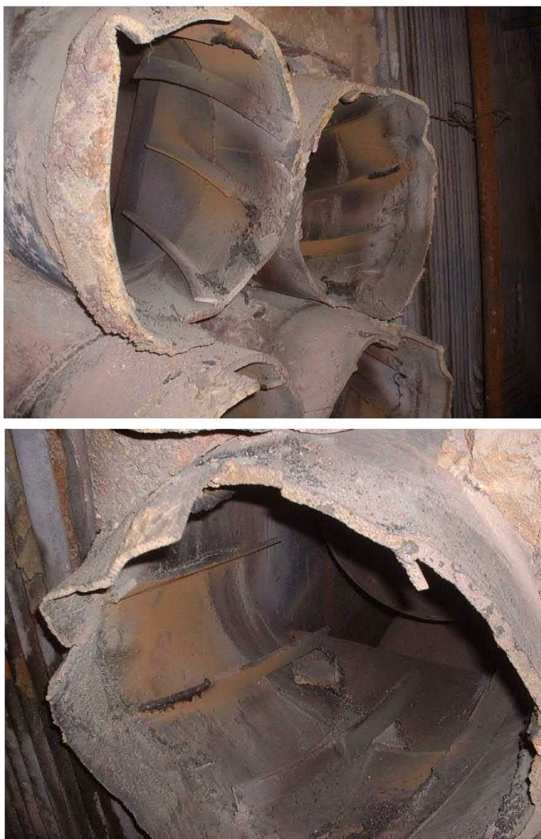
Obr. 5.46 Vnější ústí práškových hubic po opotřebení ablací s detailem (dole)
