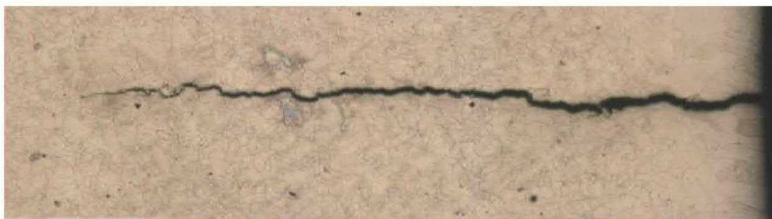
Obr. 8.29 Zoxidovaná trhlina po tepelném zatížení
